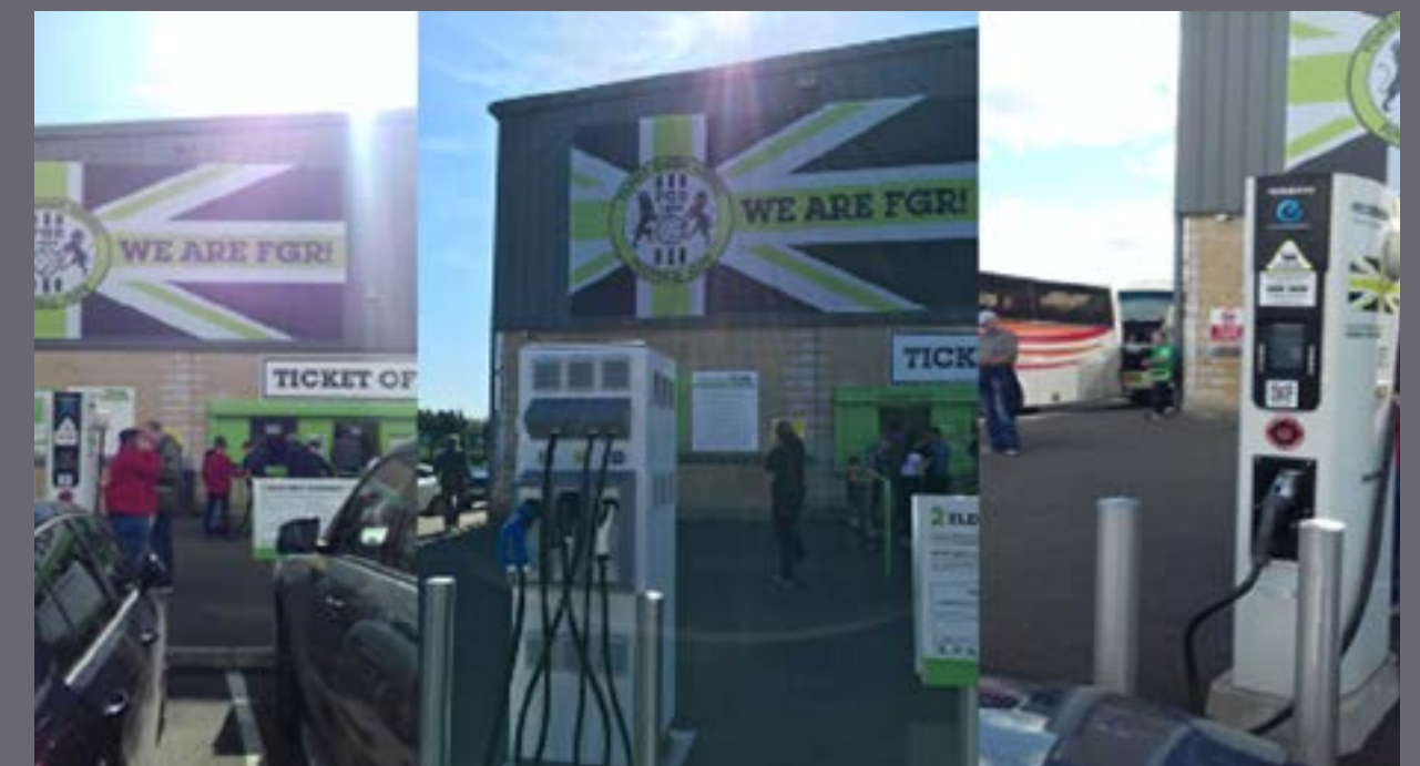
Foto 1: Puntos de recarga eléctrica para automóviles a la entrada de las instalaciones
